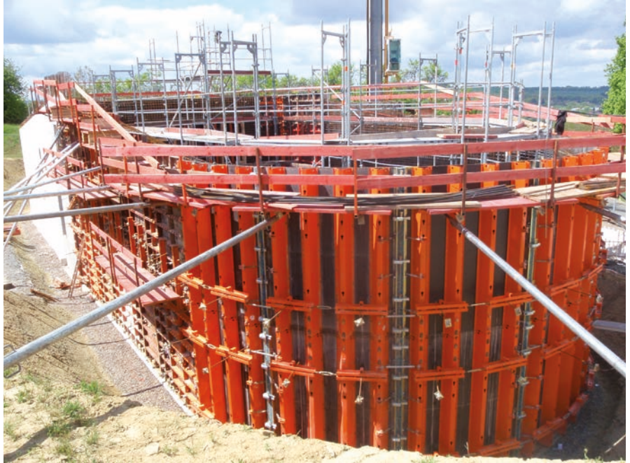
Elevated tanks, D-Galgenberg; Wolf & Sofsky SF Tief- und Ingenieurbau GmbH, D-Zweibrücken
