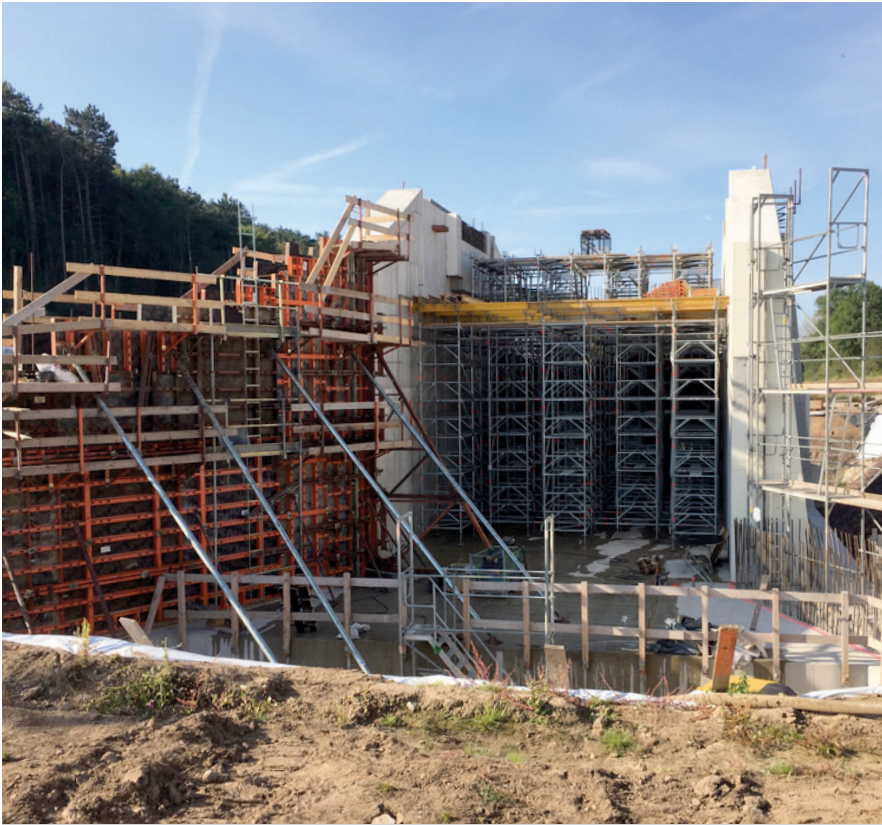
Retention reservoir, D-Querfurt; Umwelttechnik und Wasserbau GmbH, D-Blankenburg
