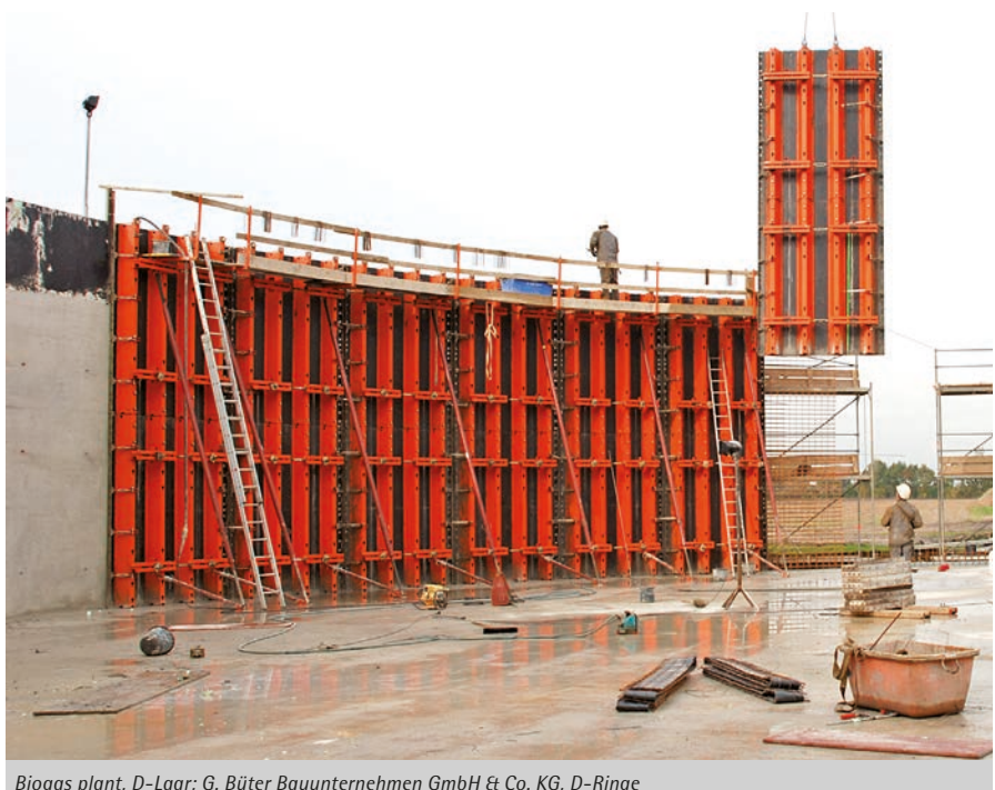
Biogas plant, D-Laar; G. Büter Bauunternehmen GmbH & Co. KG, D-Ringe
